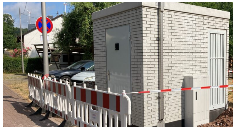
Glasfaser-Hauptverteiler in Horbach
